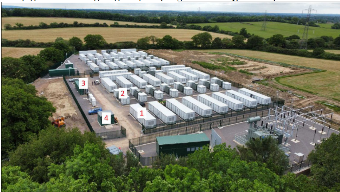
БЕС блок: 1.Контейнер с батерии, 2.Инвертор с трансформатор; 3.Система за управление; 4.Електрическа станция средно напрежение (MVPS)
